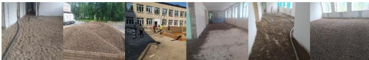
Рисунок №3. Ход производства работ по устройству керамзитового слоя Этап №3. Пролитка цементным молочком керамзитового слоя
